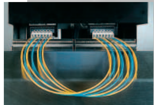
Optische Prüfung der Einlegetiefe
